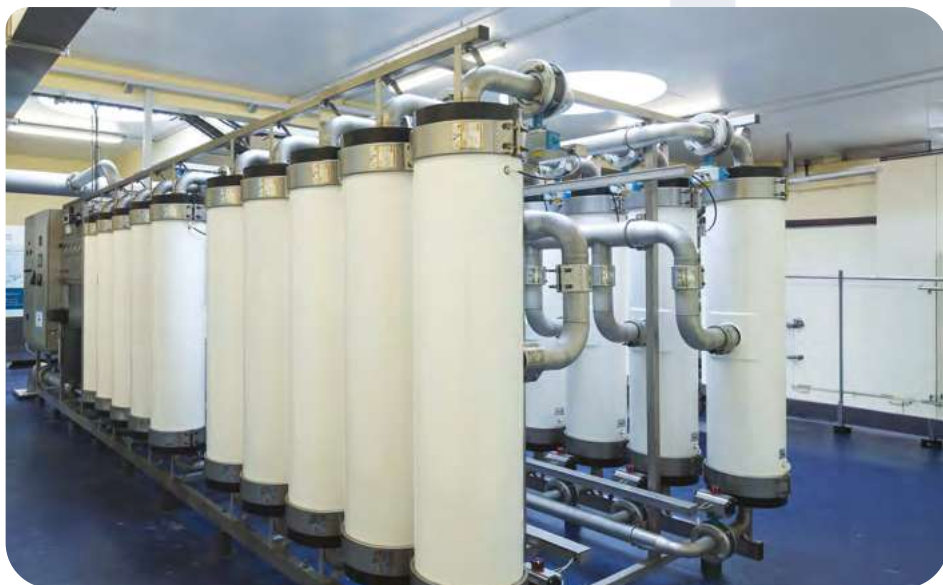
Des études ont été lancées dans le cadre du projet de doublement de l'usine de traitement de l'eau à Chevilly (Excenevex).
