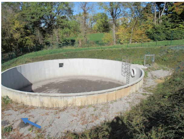
Déversoir d'orage Voua Bénit
